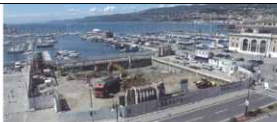
Scavo di sbarramento per il raggiungimento della quota del secondo livello interrato Excavation works to reach the second basement level's depth
