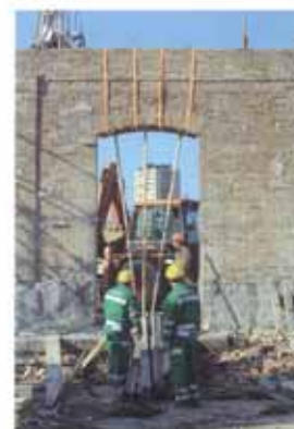
Imbracatura dei conci murari perimetrali da recuperare. Binding of the wall blocks to restore.
