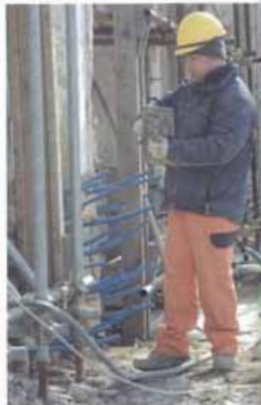
Iniezioni sul basamento di armatura, funzionali al consolidamento statico delle murature Injections on the sandy base which were functional to the static consolidation of the walls
